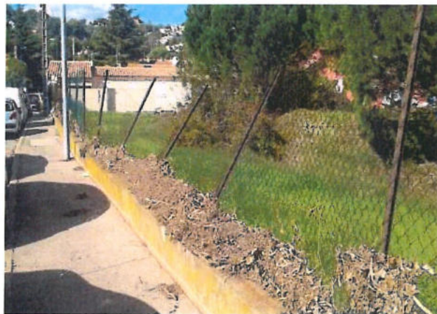
FIGURE 19 : PLOIEMENT DE CLÔTURES SOUS L'EFFET DE L'EAU – CRUE DU 03/10/2015
