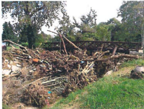
Passerelle du Golf
